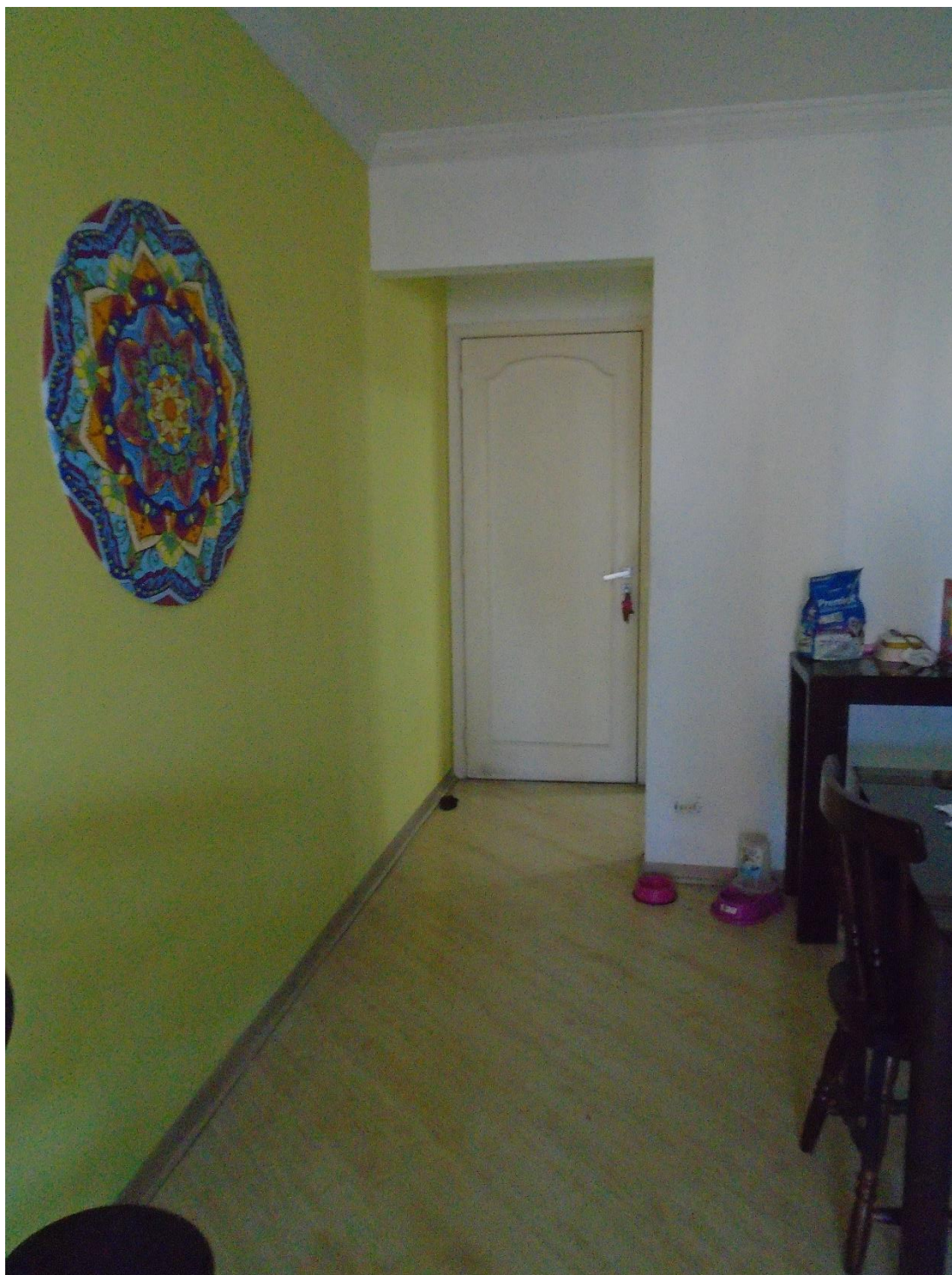
FOTO 08 – NECESSIDADE SUBSTITUIÇÃO TACOS DANIFICADOS POR IFILTRAÇÃO.
