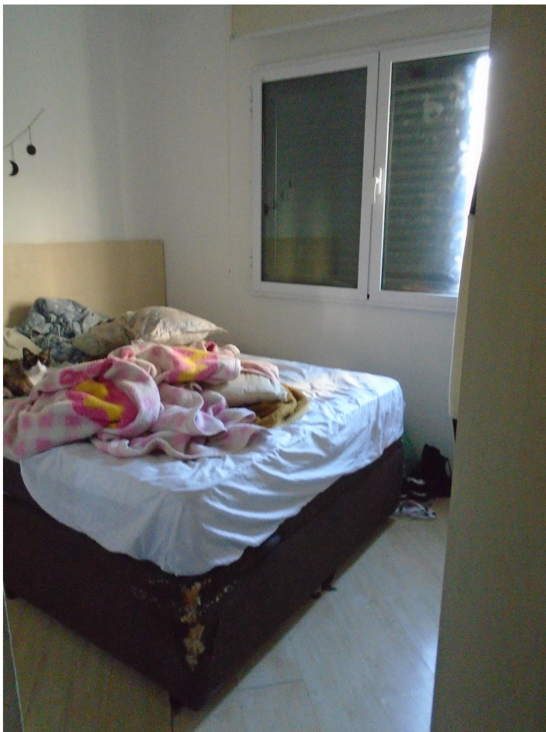
FOTO 08 – NECESSIDADE SUBSTITUIÇÃO TACOS DANIFICADOS POR IFILTRAÇÃO.
