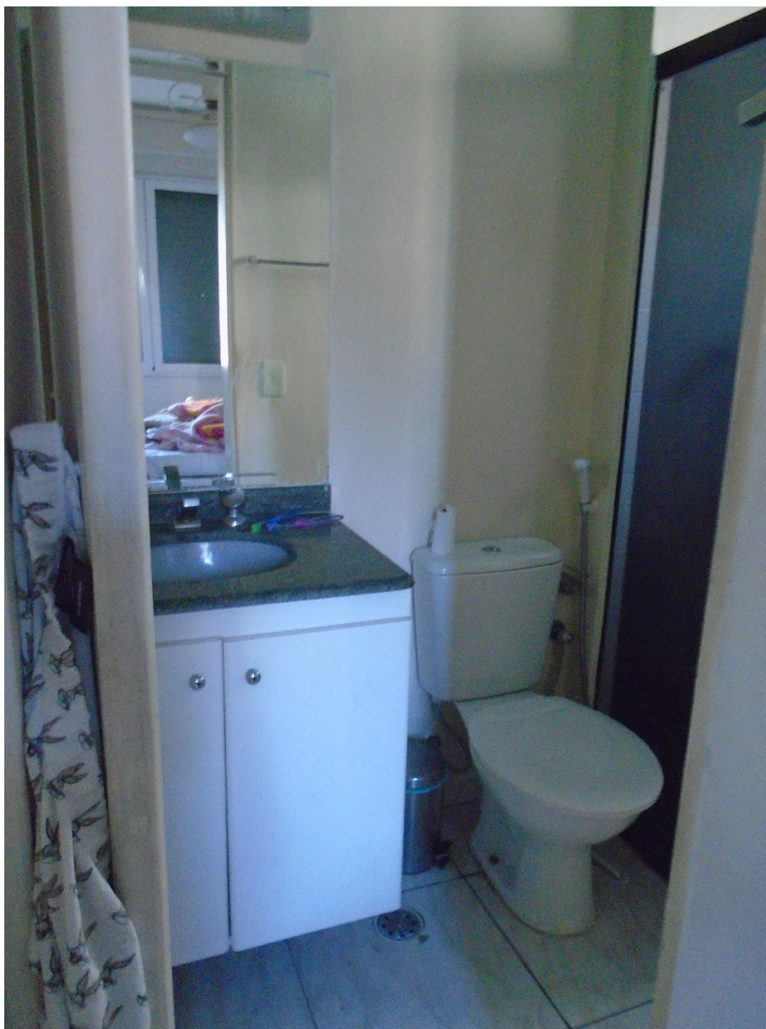
FOTO 08 – NECESSIDADE SUBSTITUIÇÃO TACOS DANIFICADOS POR IFILTRAÇÃO.
