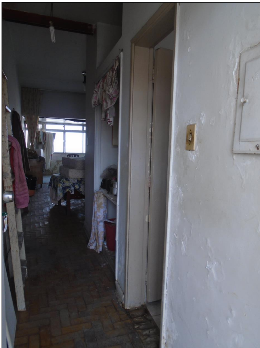
FOTO 06 – ASPECTO DO ESTADO IRREGULAR PAREDES E PISO.
