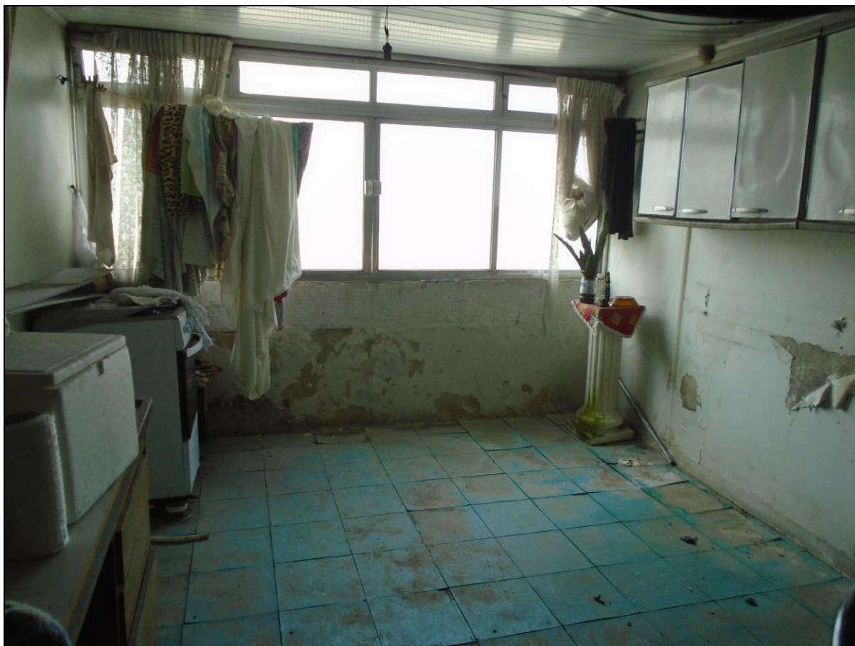
FOTO 11 – DETALHE DO ESTADO DO PISO E PAREDES PARA SUBSTITUIÇÃO GERAL.
