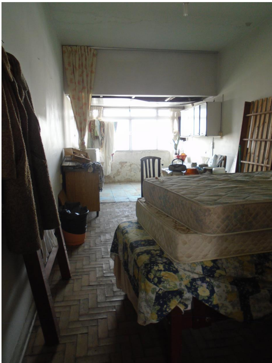
FOTO 07 – DESPREENDIMENTO TACOS E DETERIORAÇÃO PINTURA PAREDES.
