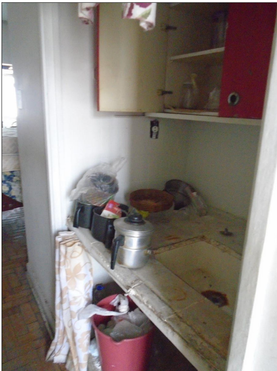
FOTO 10 – PIA COM CORROSÃO PONTO VÁLVULA CUBA.
